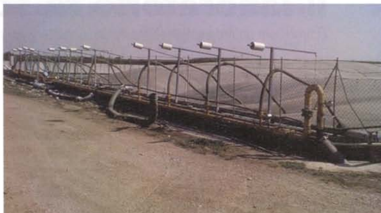
Centrale di produzione biogas
