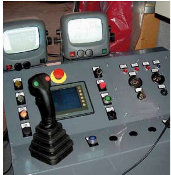
↳ Interno cabina, pulpito comandi
